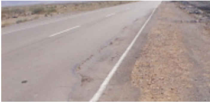
Figura 10. Fisuración de borde Fuente: Dirección de Vialidad-Chile, 2003
