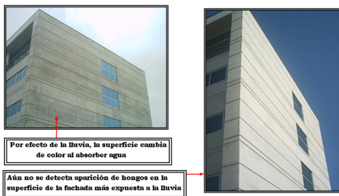
Fig. 25 Muro norte edificio Facultad de Medicina Universidad de La Frontera
