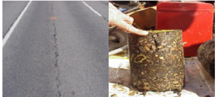
Figura 12. Fisuración longitudinal descendente- top down cracking Fuente: Harmelink and Aschenbrener, 2003
