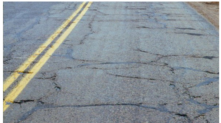
Figura 9. Fisuración en bloque
