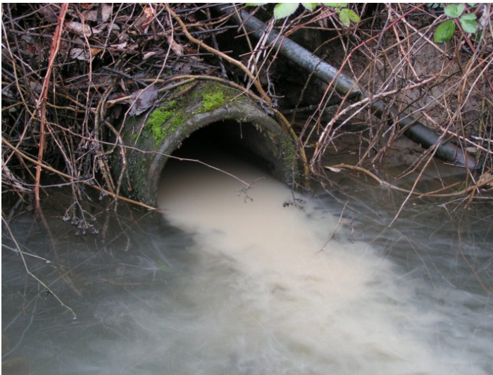
Figura 1. Vertido de colector de aguas lluvias al medio natural.
