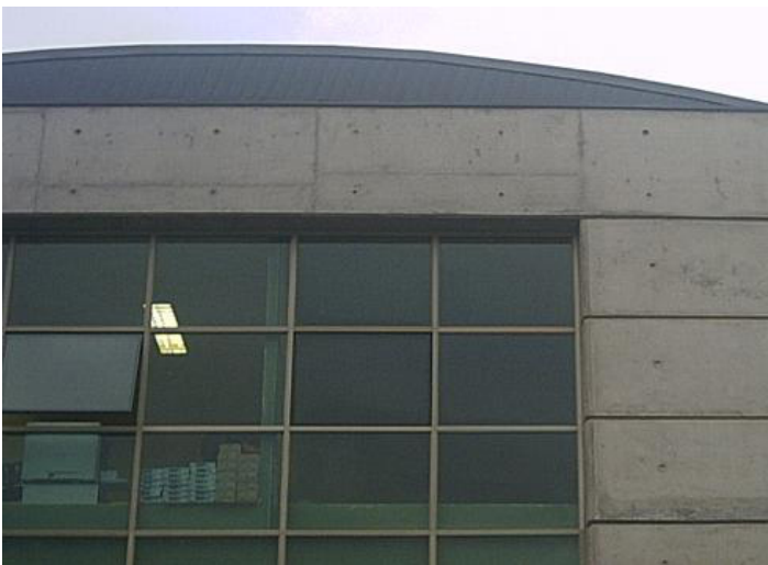
Fig. 7 Edificio Liceo Camilo Henríquez, Temuco (intención de Hormigón Arquitectónico no lograda).
