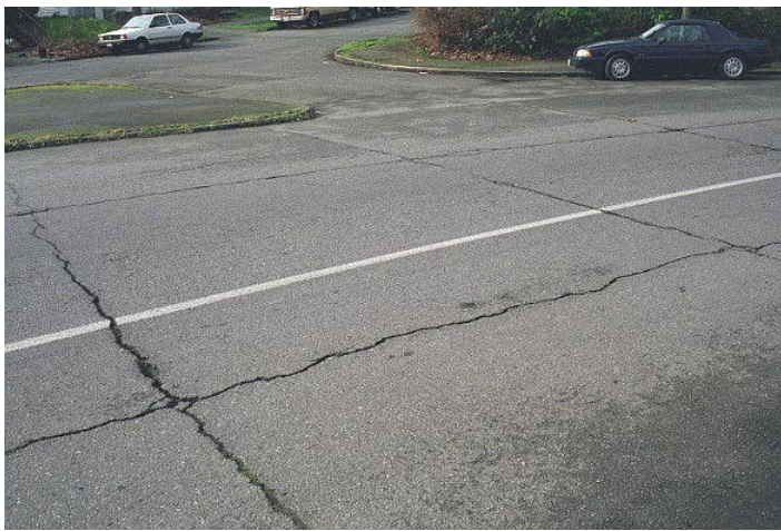
Figura 13. Fisuración por reflexión de juntas Fuente: Pavement Interactive, Asphalt Pavement Guide
