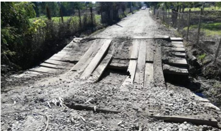
Figura 9. Puentes en mal estado en la Región de Ñuble. Fuente: Diario La Discusión (1 de septiembre de 2020).
