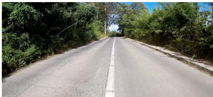
Figura 3. Estado general pavimento a 6 años de construido
