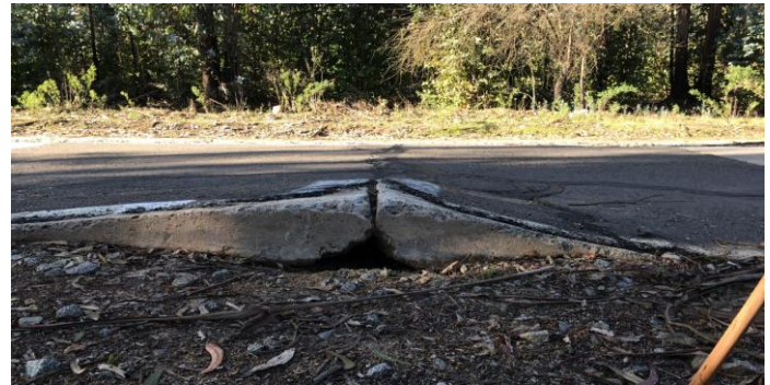
Figura 4. Caso extremo de IRI en pavimento de hormigón.
