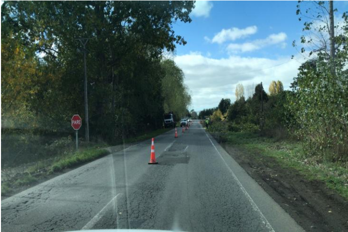
Figura 2. Caso extremo de grietas en pavimento flexible.
