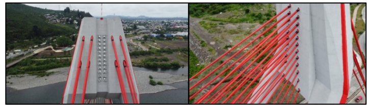
Figura 6. A la izquierda, cabezal del mástil, anclajes de tirantes delanteros y distribución de tirantes de retención. A la derecha, distribución de tirantes delanteros en cabezal del mástil (© Civilab UACH).
